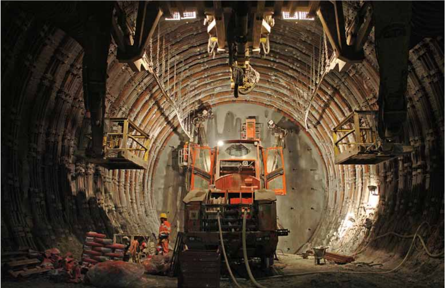
Bohrarbeiten an der «Tunnelbrust» in Sedrun: Sobald Probleme auftreten, stehen die ETH-Experten den Ingenieuren vor Ort beratend zur Seite. (Bild: AlpTransit Gotthard AG)
